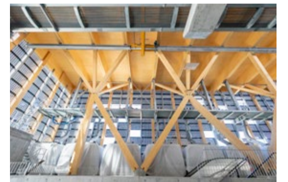
Innenansicht vom Primärtragwerk bei der Talstation // Bildrecht: Zermatt Bergbahnen
